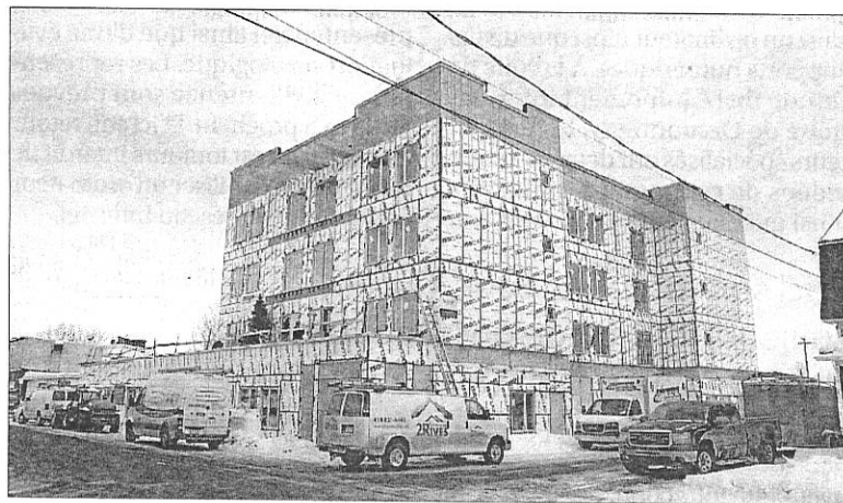
Le nouveau bâtiment de l'OMH, un projet qui s'intègre dans la revitalisation de la rue Hertel, accueillera dès juillet ses premiers locataires. — PHOTO: SYLVAIN MAYER
